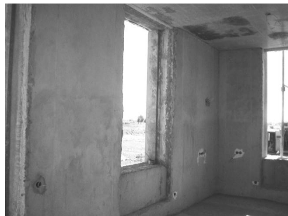
Рис. 2. Фрагмент внутреннего помещения жилого двухэтажного дома возводимого с использованием стеновых газобетонных панелей
